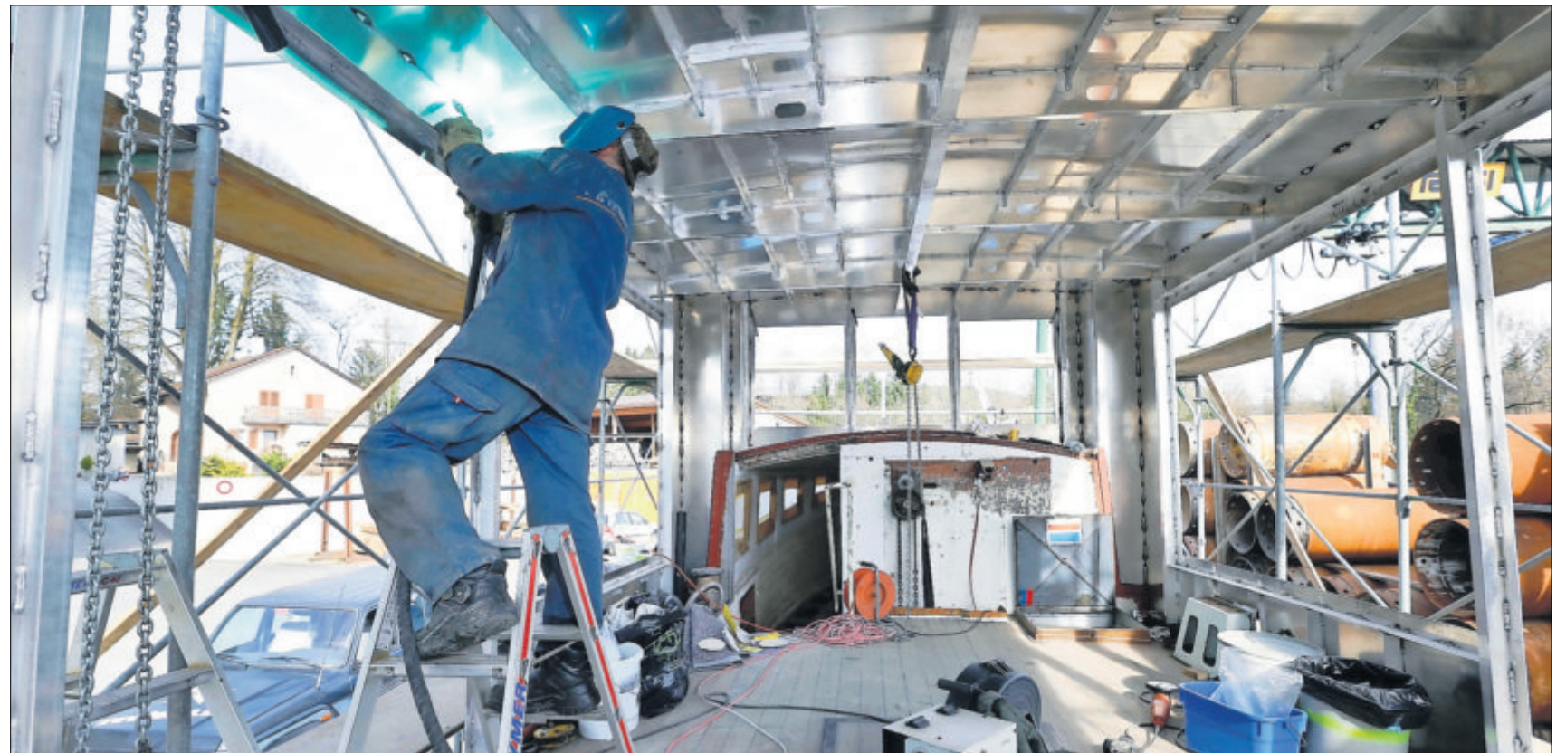
Noch wird auf dem Baarer Gulm an der Renovation des MS «Schwan» gearbeitet, das aber schon bald wieder auf dem See im Einsatz sein soll.
